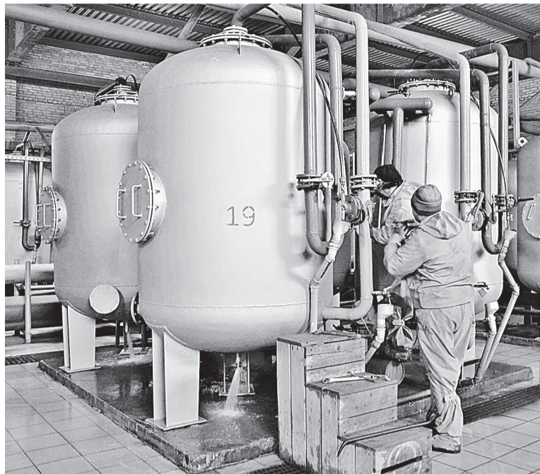
Фильтры станции обезжелезивания промывают дважды в сутки
